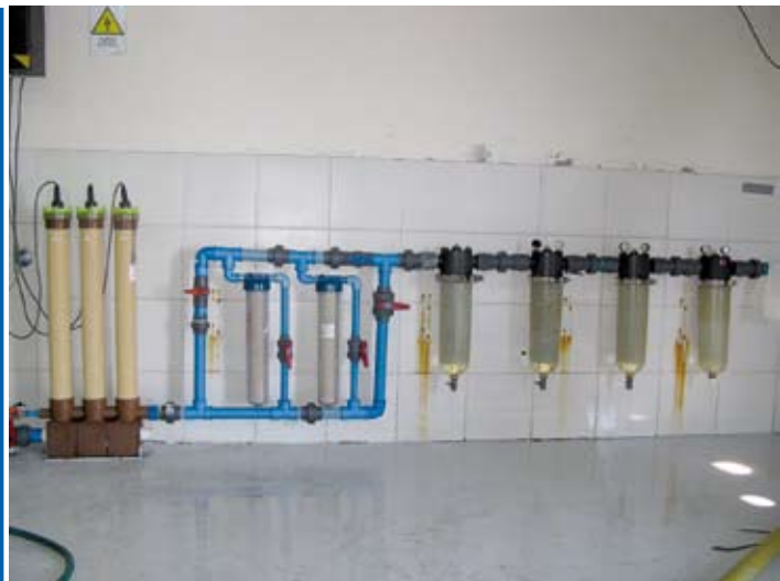
Fig. 7. Sistema de filtrado y tratamiento de agua de mar
